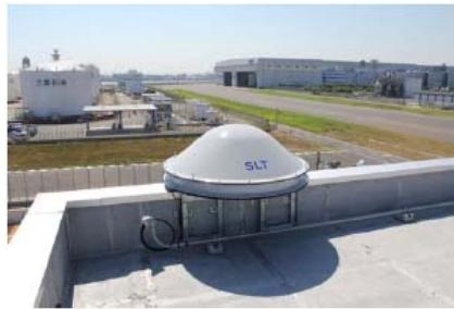
図 4 免振装置を施した基準局アンテナ
